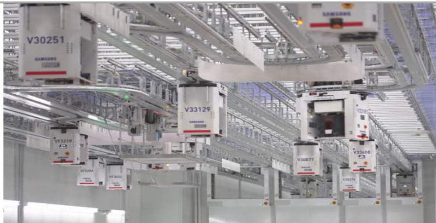
그림28 반도체 이송 설비 OHT(Overhead Hoist Transport)
