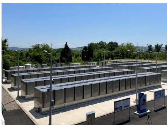
블룸에너지 SOFC (에너지서버)
